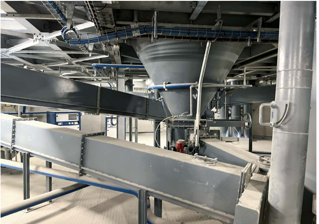
[photographies] Le ciment est stocké dans les cellules puis acheminé suivant les instructions fournies par le pont de chargement
